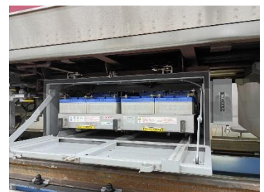
蓄電池（東西線車両）
