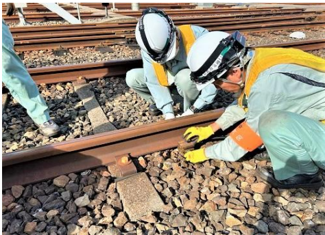
電気区での訓練
