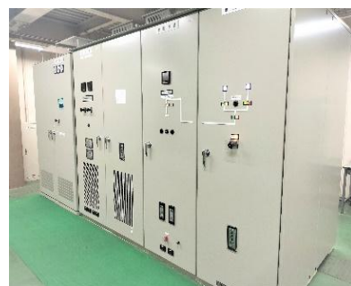
更新した電力設備（竹田車両基地）
