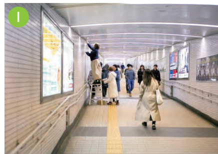
通路にセンサーチャイムを設置。
