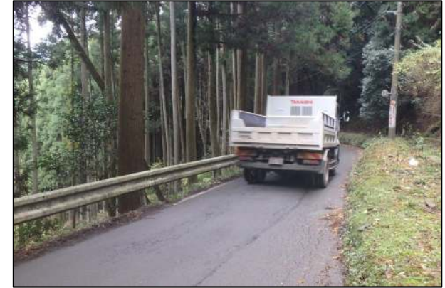
<写真②> 現道の線形不良の幅員狭小箇所（中間付近から南を望む）
