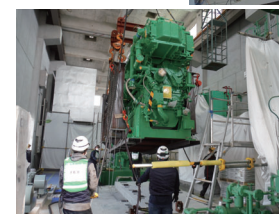
洛南排水機場（原動機更新）
