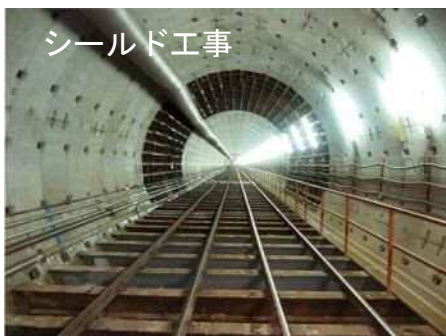
貯留幹線（堀川中央幹線）
