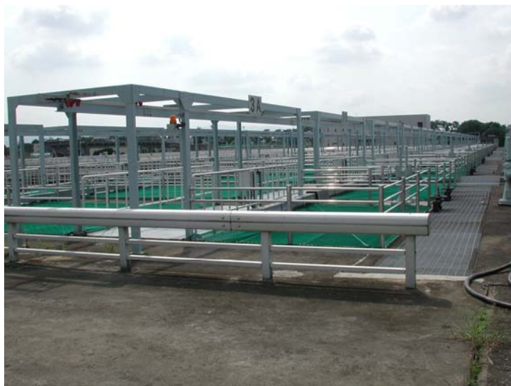
既設高度処理施設
