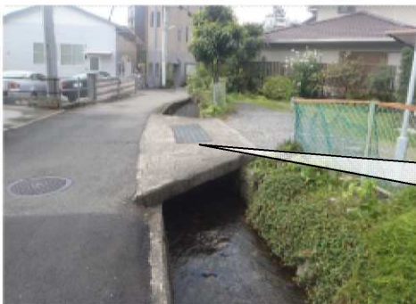
無許可通路橋の事例
