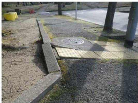
根上りによる損傷
