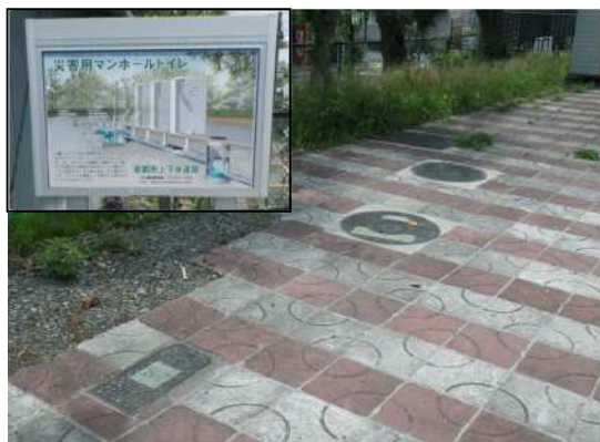
災害用マンホールトイレ
