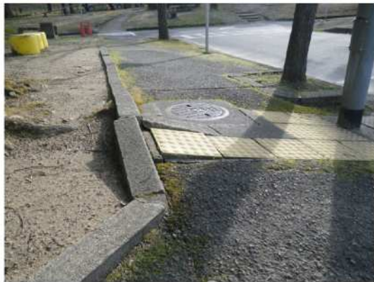
根上りによる損傷
