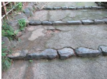
○階段踏面部のモルタルの剥離
