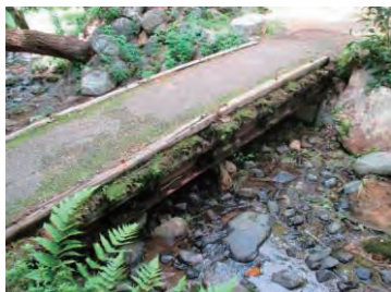
○滝口の木橋の破損
