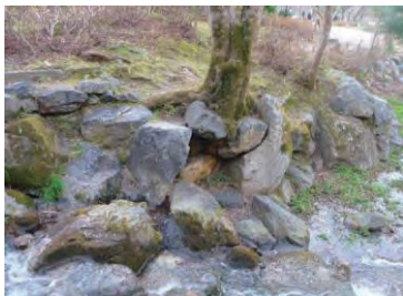
○樹木の根による空隙ができた 護岸石積み
