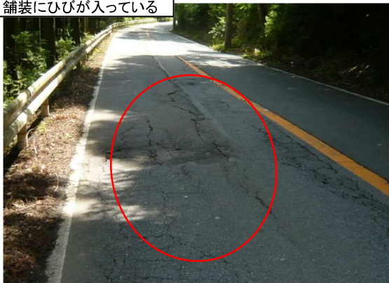
舗装にひびが入っている
