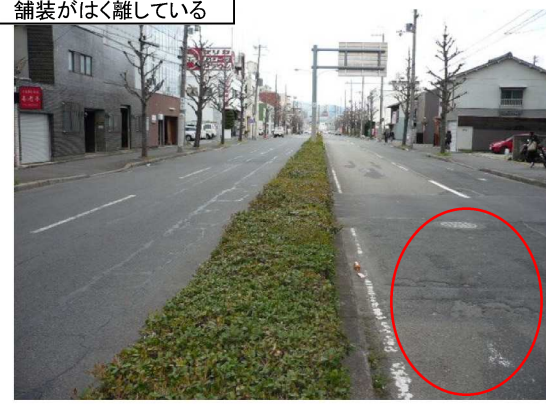
舗装がはく離している
