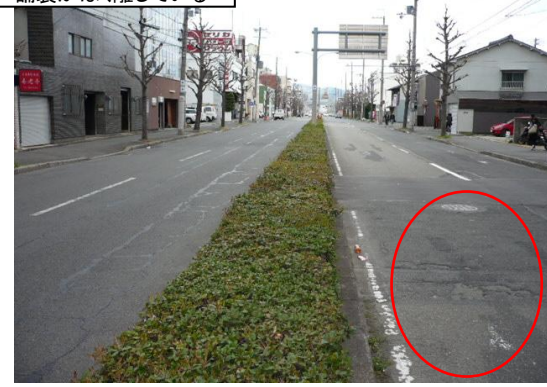
舗装がはく離している
