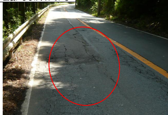
舗装にひびが入っている
