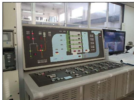
写真 5-3-2 中央監視盤 (2004 年更新)
