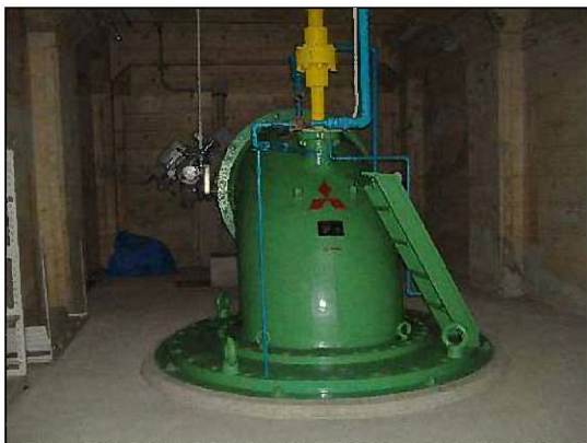
写真 5-3-1 1号主ポンプ (1974 年設置, 2001 年更新)
