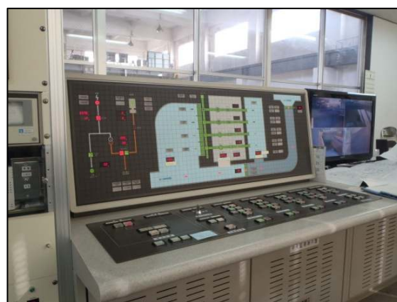
写真 5-3-2 中央監視設備 (2004 年更新)
