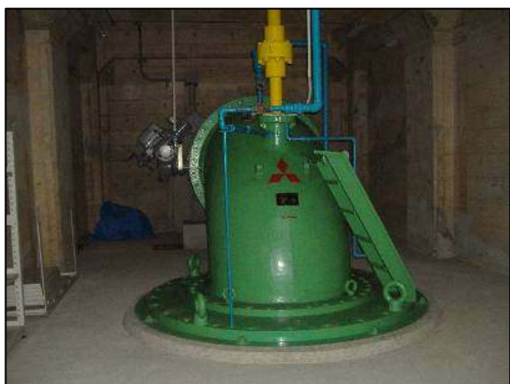
写真 5-3-1 1号ポンプ (1974 年設置)
