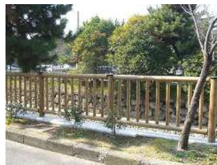
間伐材を用いた転落防護柵。
