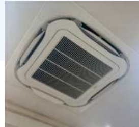
伏見大手筋商店街加盟店 空調機器の更新
