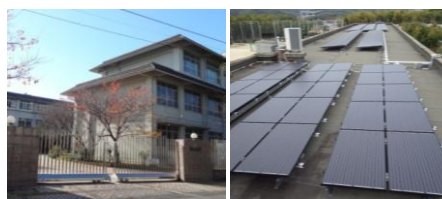
＜大原野中学校（発電出力 60kW）＞
