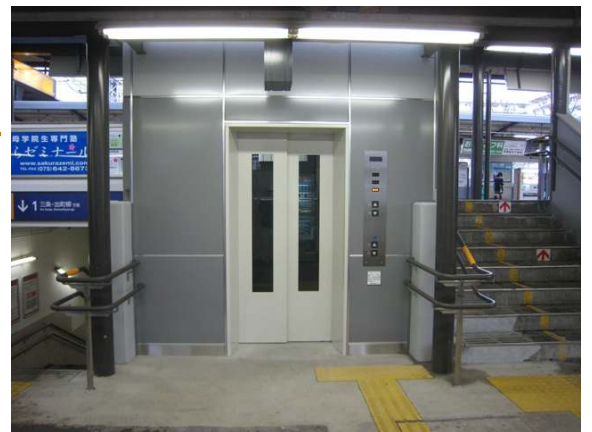
ホームと改札を結ぶエレベータ
