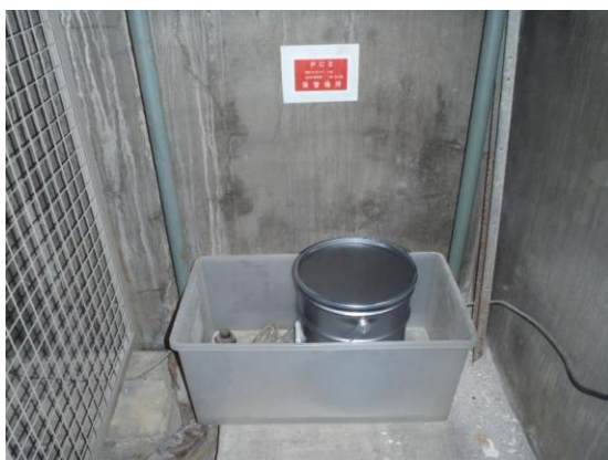
▲PCB 廃棄物①
