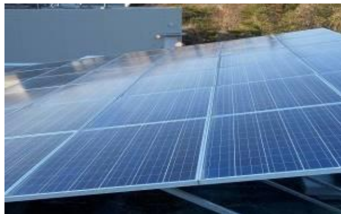
写真④太陽光パネル
