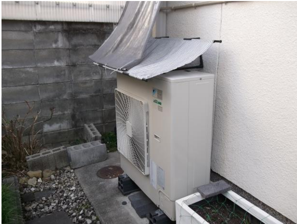
室外機の日よけ
