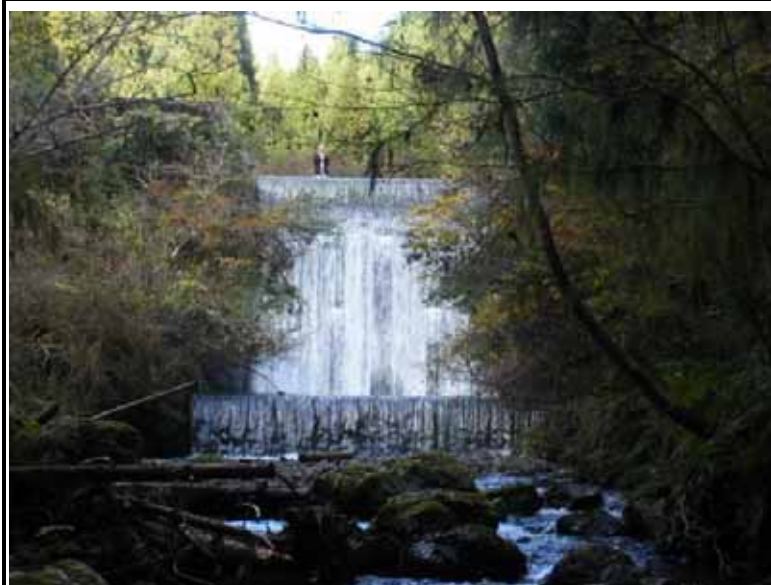
地点 16 北区雲ヶ畑中津川町 平成 23 年 11 月 24 日
