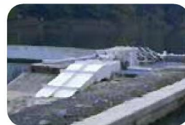
設置した小水力発電装置
