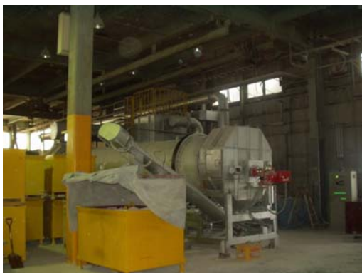
⑤ 熱処理機及び二次分離装置（2）
