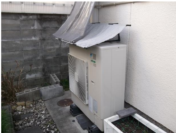
室外機の日よけ
