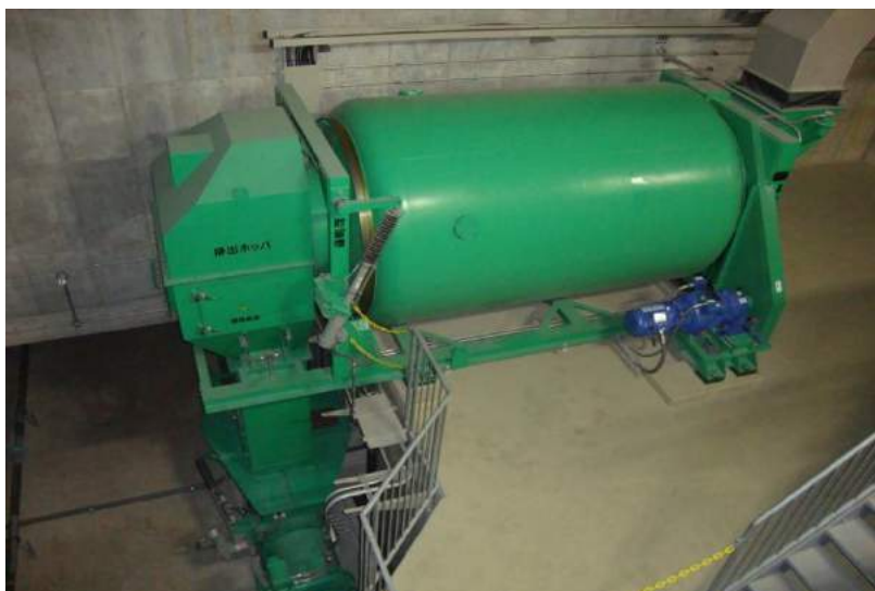
ごみ貯留設備(有明セントラルタワーB2F)
