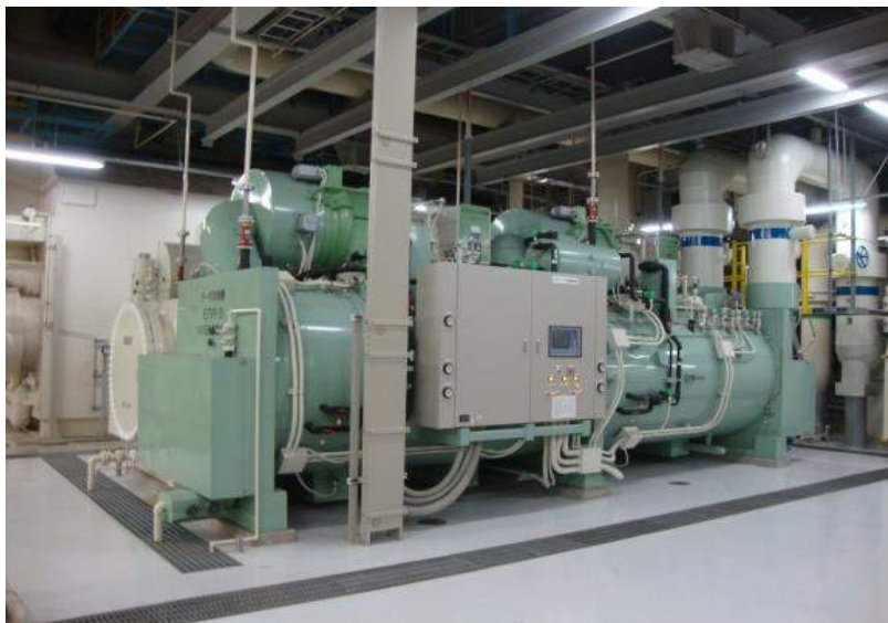
ターボ冷凍機
