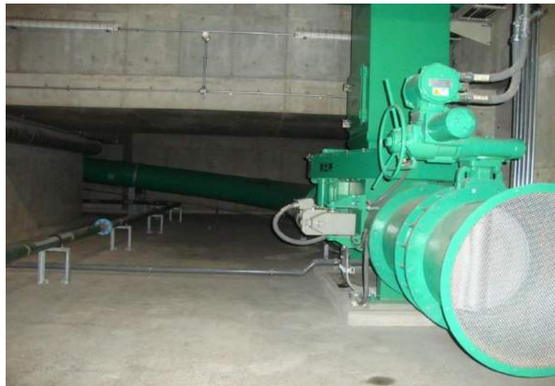
可燃ごみ圧送管(有明セントラルタワー)
