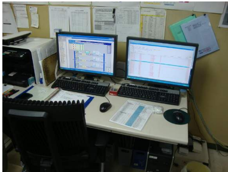
有明フロンティアビル(Johnson製)
