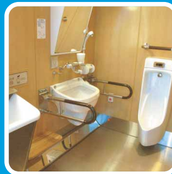
きよみず快適トイレ内部
