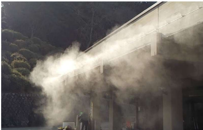
配管型ミスト（蹴上浄水場）
