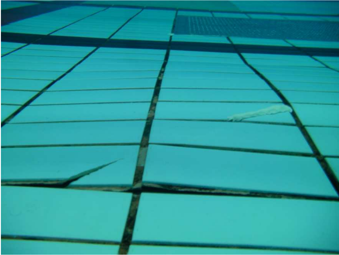
破損箇所の状況
