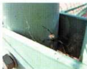
フェンスの支柱のすき間
