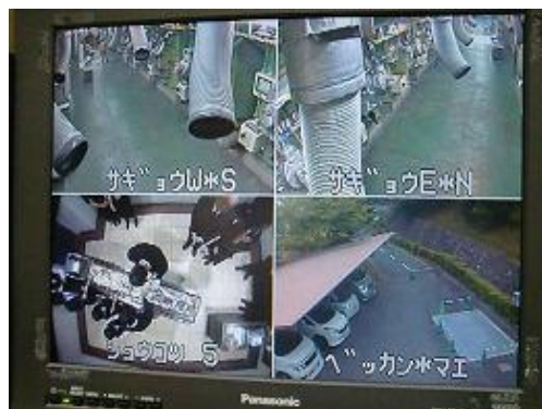
コントロール室（集中監視室）のパネル
