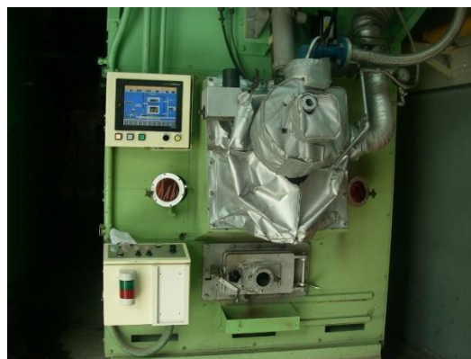
予備室に納棺確認後，納棺機により火葬炉内へ挿入し火葬開始（制御モニター，制御盤を操作）
