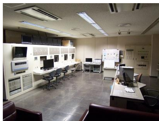
コントロール室
