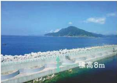
防波堤のかさ上げ
