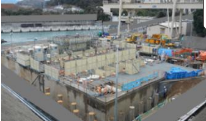
〔竜巻飛来物対策設備設置前〕
