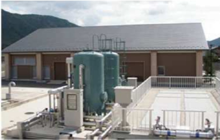
再整備事業により完成した山国浄水場(京北中部地域水道)
