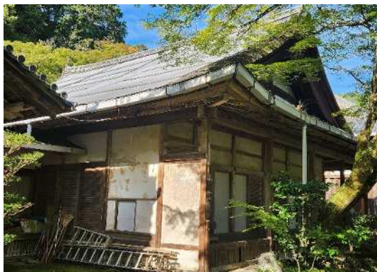
修理予定箇所
