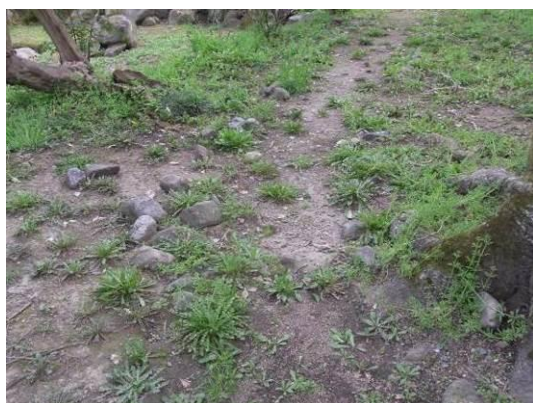
園路 縁石散乱状況
