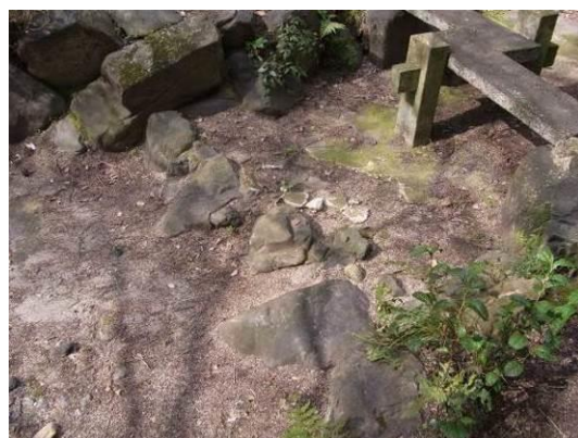
園池 池底のタタキ毀損箇所
