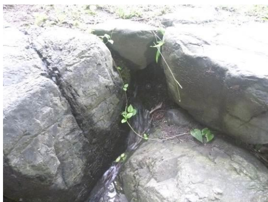
園池 池庭護岸の毀損部位
