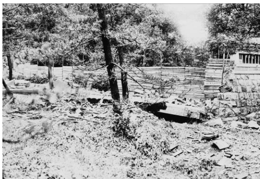
〔写真 1-2〕西側煉瓦塀の倒壊（「昭和10年下鴨別邸 水害状況写真（付別邸図面）」写1404）
