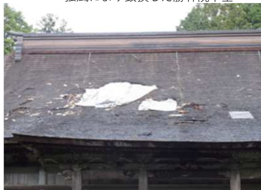
図表 12 平成 29 年（2017）、30 年（2018）の 強風により毀損した勝林院本堂
