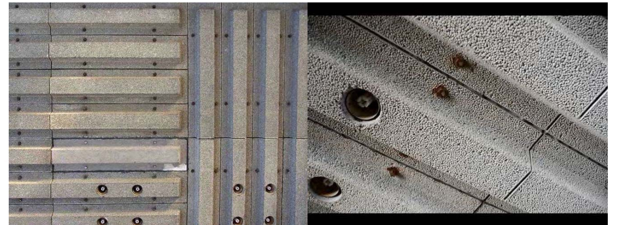
左：現況、一部材料の交換が確認できる
