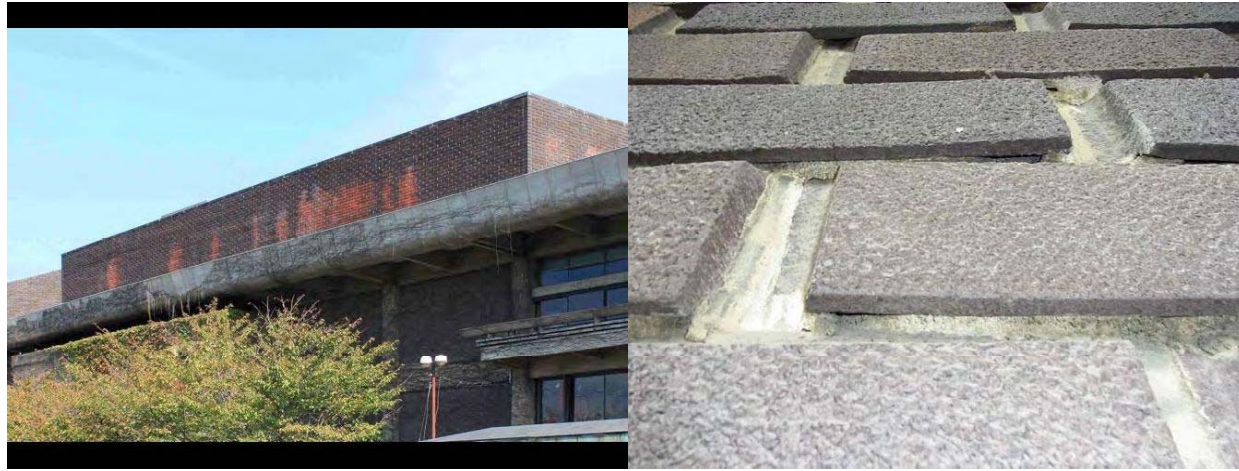
左：第2ホール上部ボリューム，外壁汚れ補修が目立つ 右：壁煉瓦タイルの詳細，精度のばらつきが激しい
