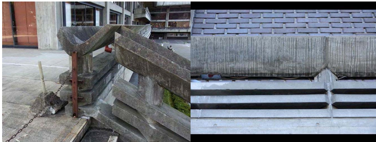
左：PC手摺現況，雨掛りのある箇所は劣化が進行している 右：手摺見上げ，経年による雨水汚垂が発生している
