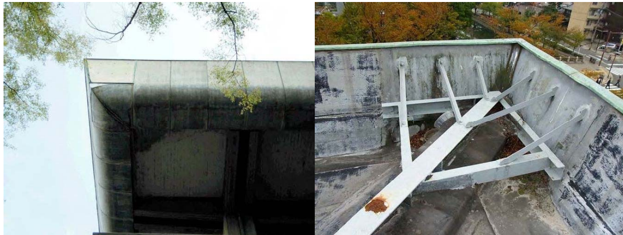
左：出隅部が鉄板にて仮補修されたままとっている 右：出隅部の現況背面
