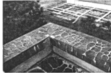
笠木部分のひび割れ状況
