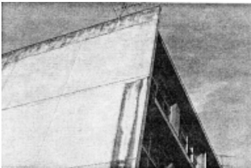
ひび割れによる漏水と外壁の汚損
