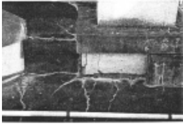
防水立上り部分の劣化
