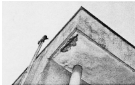
ひび割れによる漏水から，鉄筋腐食によるモルタルの剥落（軒裏）
