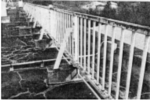
手すりの塗装の劣化による腐食
