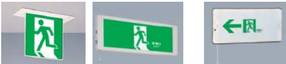
避難口誘導灯
