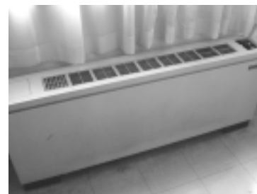
ファンコイルユニット
