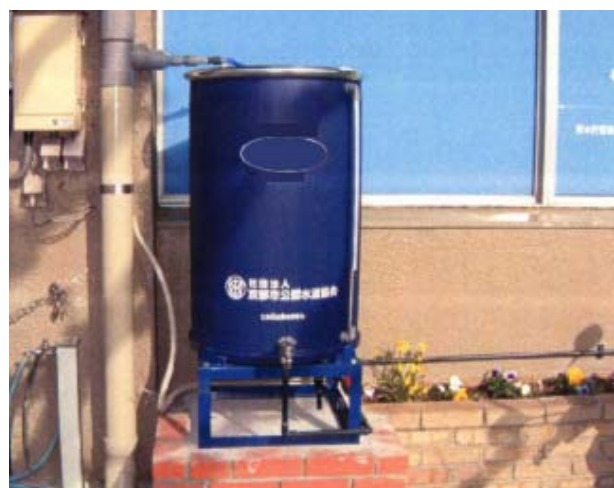
雨水貯留施設の設置状況(Ⅲ(12)-30)
