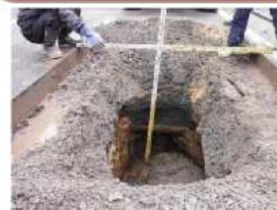
[路面下に発生した空洞の状況]
