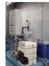
●消火訓練水ろ過装置
