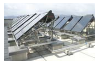
●太陽熱給湯パネル
