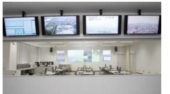
●作戦情報室・作戦支援室 平常時は、視聴覚室として使用します。緊急消防援助隊受入時には、消防局の「消防指令センター」に直結し、リアルタイムで収集した災害情報などを元に、効果的で効率的な部隊運用を行います。
